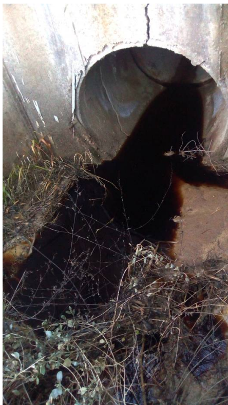
Έξοδος αγωγού ομβρίων
